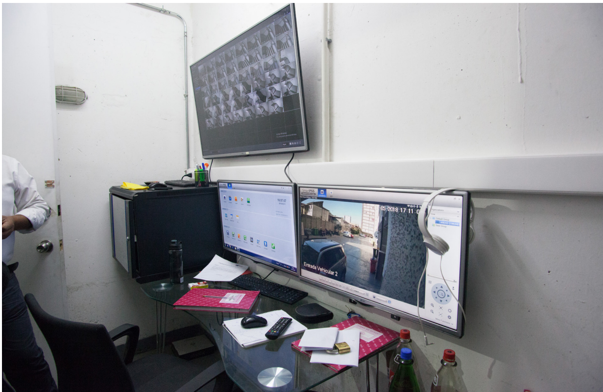
Figura 6: Sala de cámaras de seguridad.
