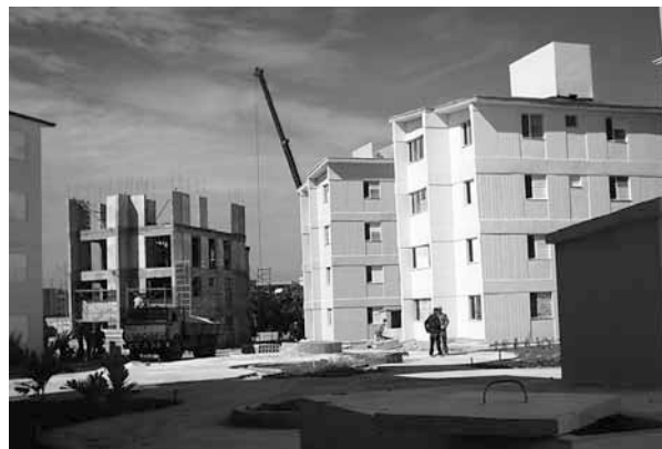
FOTO 18: Nueva urbanización en Holguín para viviendas de médicos. Foto tomada por la autora en octubre 2007.
