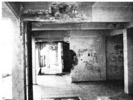
FOTO 3 Galerías deshabitadas degradadas.
